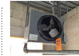
167 TTP Heat Exchanger Air Cooler
